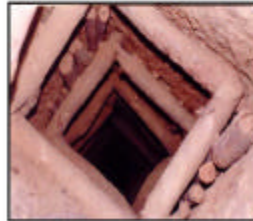
Puits avec soutènement de bois et d'autres matériaux de la forêt du site de Sosso
