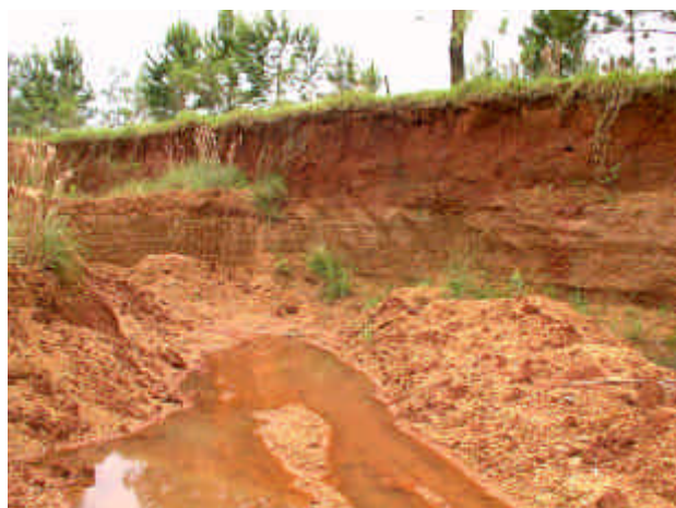
Figura 1: Vista del sector sudeste hacia el norte. El primer plano (abajo a la izquierda) correspondería al cierre temporal del recinto (cota 89).
