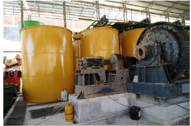
Foto 35. Tanques cianuradores y molino de bolas
