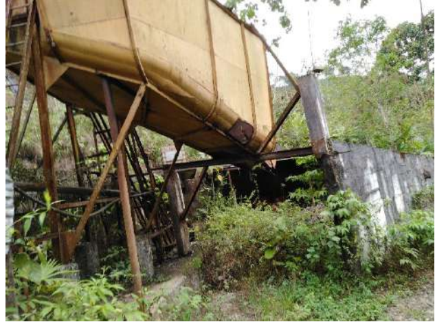
Foto 13. Facilidades abandonadas – Sector Alvarado
